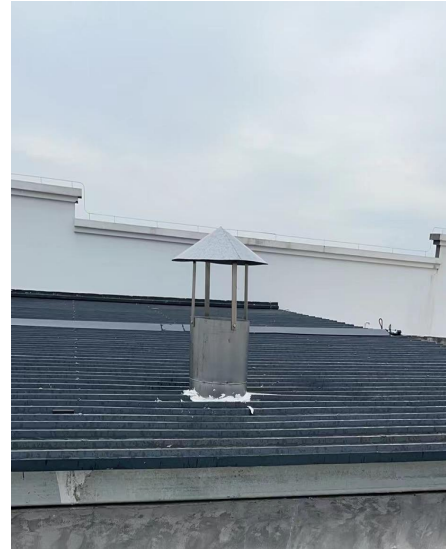
干燥废气排气筒
