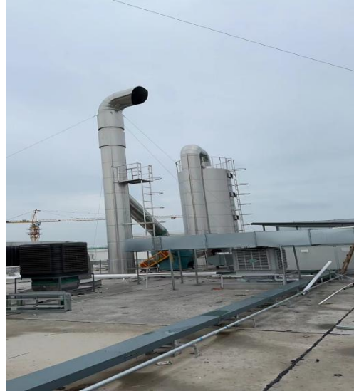
反应釜废气治理设施及排气筒
