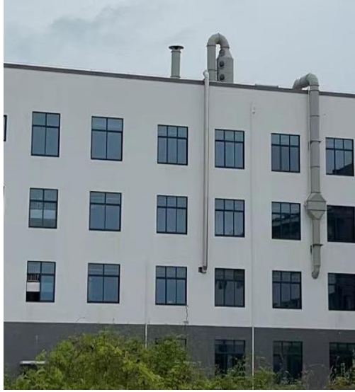
实验室废气治理设施及排气筒
