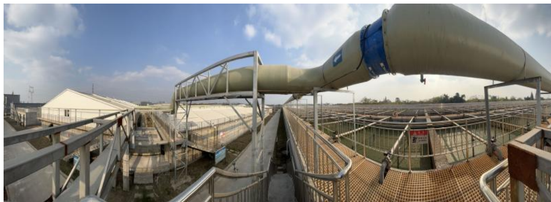
图 3.5-5 生产废水污水处理站全景图
