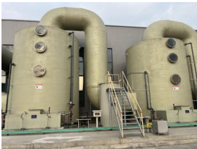
图 3.5-2 次氯酸钠氧化+碱液喷淋现场图
