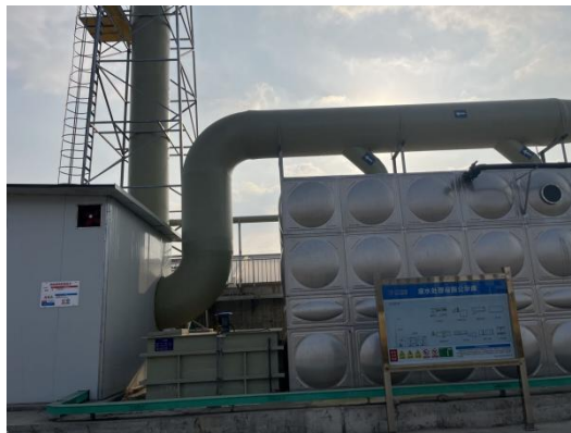
碱液喷淋+生物除臭现场图
