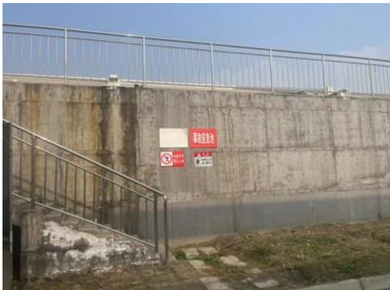
图 3.5-9 现有项目事故应急池建设情况
